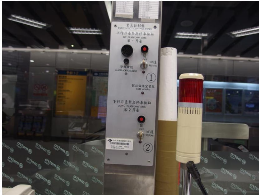
圖 9 站務室 (PAO) 緊急停車控制盤與月臺緊急停車按鈕串聯
