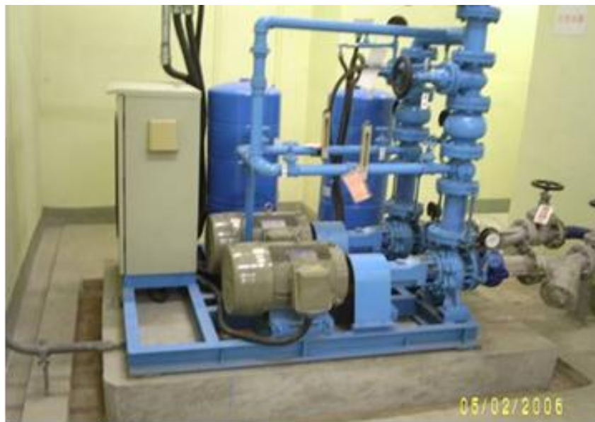
圖 4 捷運車站恆壓變頻給水泵浦
