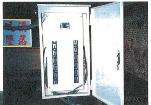
→圖十一：每一配電箱內均裝置漏電斷路器及良好阻隔設施，以防止人員任意接電
