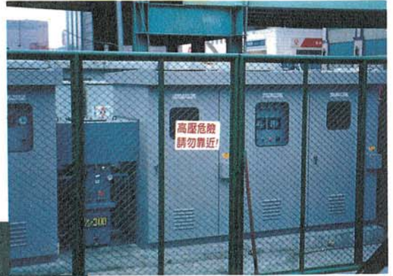
→圖八：工區內之高壓電設備皆以圍籬隔絕，並懸掛告示牌警示，且定期油漆、維護圍籬
