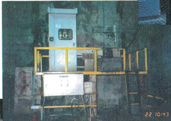
←圖九：隧道內緊急並聯啟動設備以平台架高，防止閒人隨意開啟，並懸掛警告標示牌及操作程序
