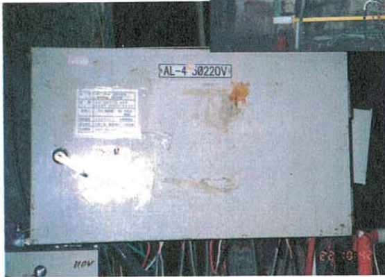
←圖十：各工區配電箱皆張貼用電種類及維護技術員姓名、用電容量，並上鎖以防勞工隨意開啟
