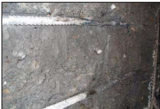
圖27 劣質連續壁壁面
