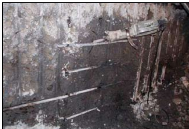
圖28 劣質連續壁鋼筋
