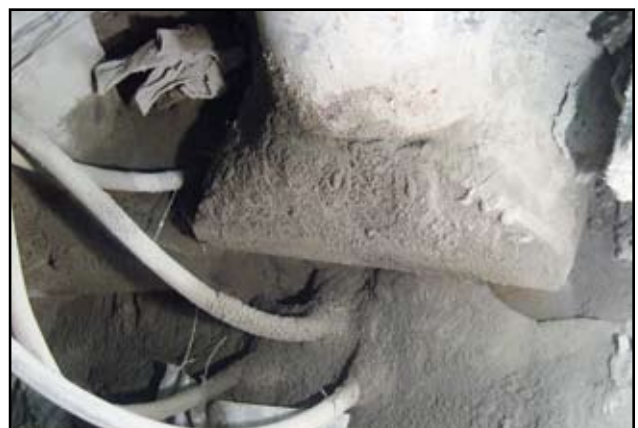
圖30 下行第3壁漏水臨時導水
