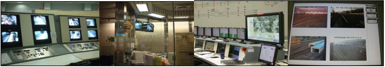
圖 9(自左而右)行控中心、車站及機廠 CCTV 系統監控
