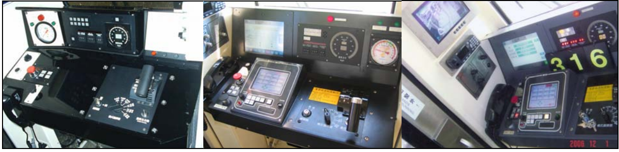
圖 1 高運量駕駛室(自左而右)土城線、新蘆線 TSIS 顯示器、新蘆線 CCTV 螢幕
