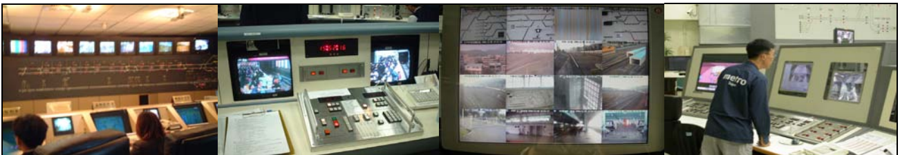
圖 11 新一代彩色 CCTV 系統監控設備
