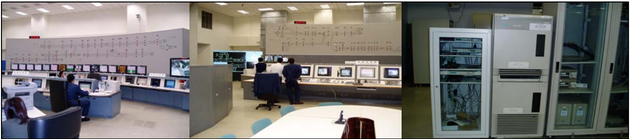
圖 15 既有交九行控中心設備(自左而右)藍線馬賽克、紅線馬賽克、主電腦設備
