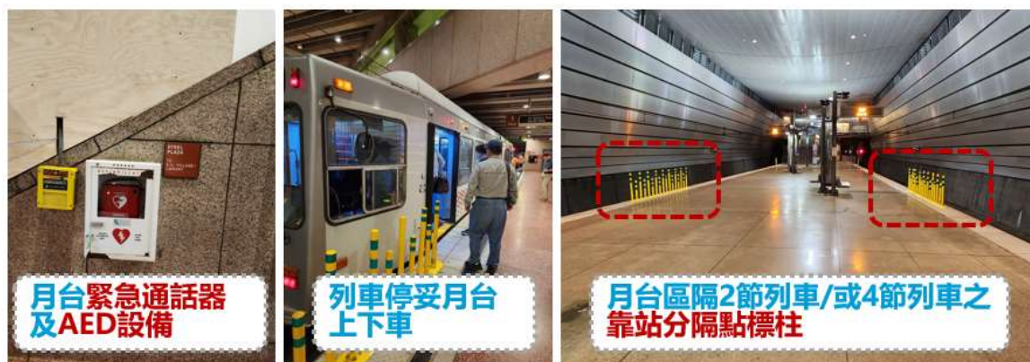
圖 32、匹茲堡區域運輸輕軌月台緊急設備及區隔 2 節列車/或 4 節列車之靠站分隔點標柱(資料來源：出國人員自行拍攝)
