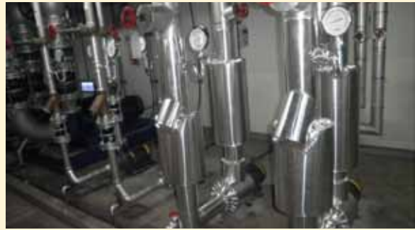
▲圖7 輔助冰水泵及輔助冷卻水泵
