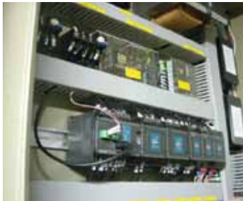
▲圖30 冰水主機連線系統 相關元件線路配置
