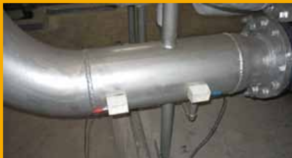
▲圖32 冷卻水管路流量測試
