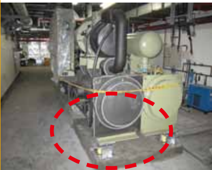
▲圖22 主冰水機的避振器安裝情形
