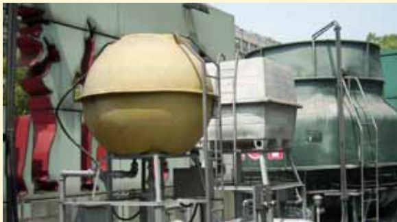
▲圖8 補給水箱及膨脹水箱
