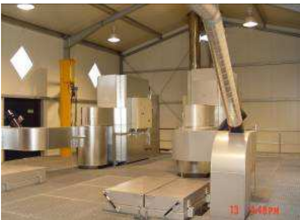
火化爐後方之除塵設備
