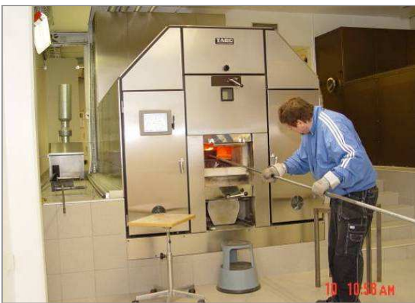
工作人員操作 TABO 火化爐之情形
