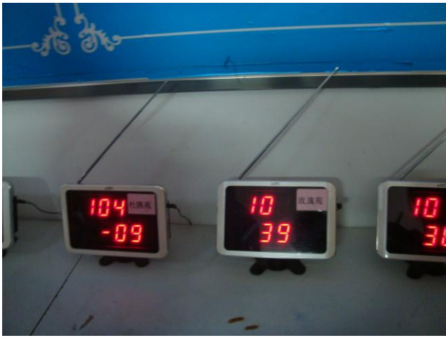
頤樂園護理站監控面板
