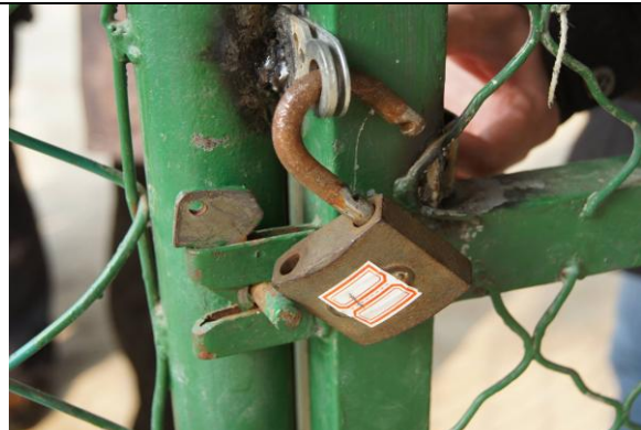
圖 4、作業門鳥嘴扣安全度不足，須進行改善與加強
