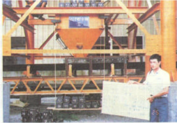
預拌廠骨材計量設備之校磅工作
