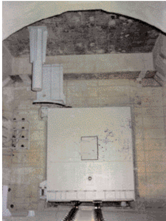
照片三 隧道全斷面擺動式防水隔艙閘門全關時情形
