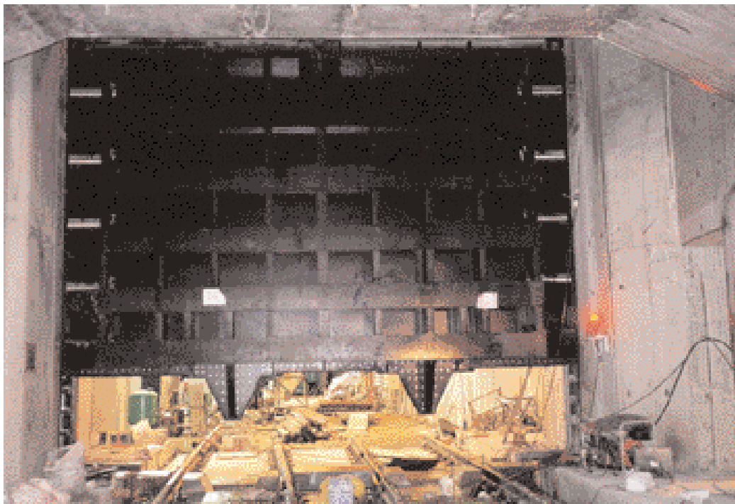
照片六 隧道全斷面擺動式防水隔艙閘門全關時情形
