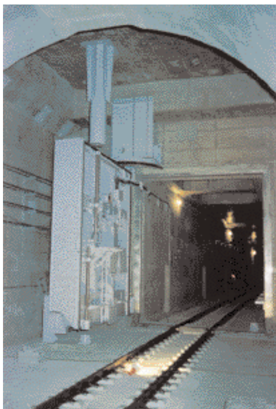
照片二 隧道全斷面擺動式防水隔艙閘門全開時情形
