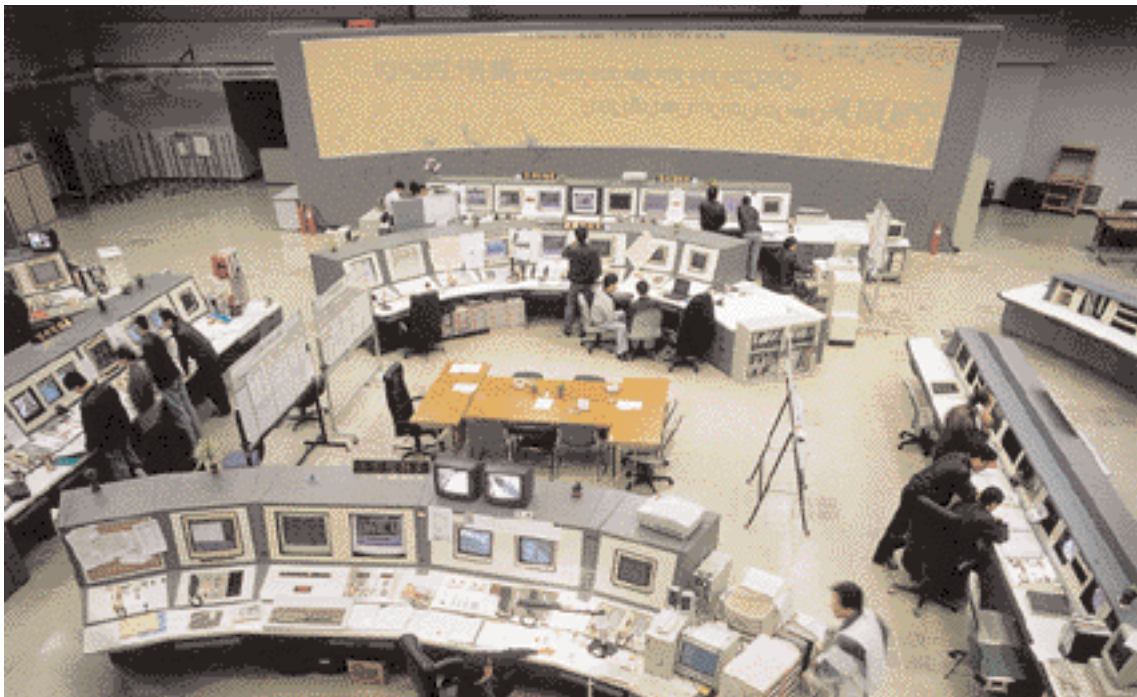
照片一 捷運行控中心主任控制員可從防水隔艙閘門總監控盤(含閉路電視監視器及警報器)及電聯車運行顯示面板，掌控隧道進水情形及捷運全線電聯車行車狀況
