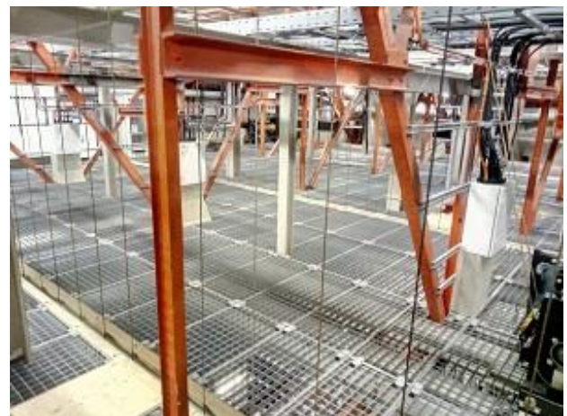
鋼棚上方捲揚機設備
