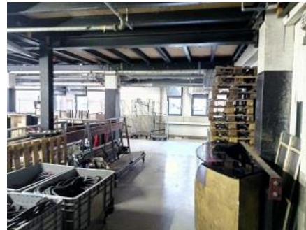
劇場地下室動力設備
