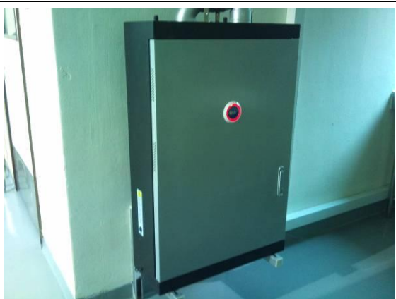
解剖房 HEPA 過濾器裝備
