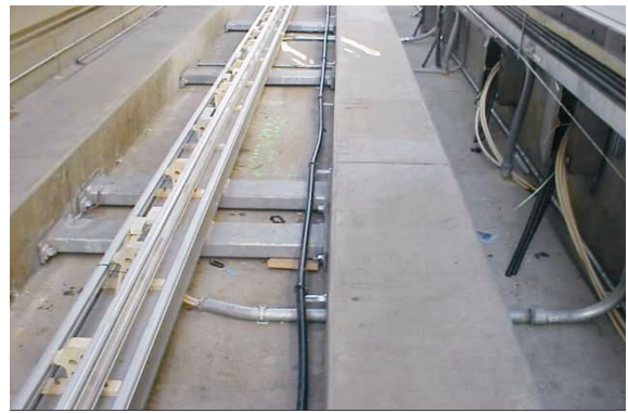
圖 10 道旁漏波電纜設置案例
