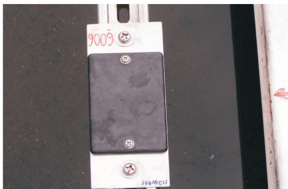
圖 3 道旁設備：信標 提供位置座標資訊
