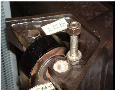
圖 4 正常扭力臂上部螺栓
