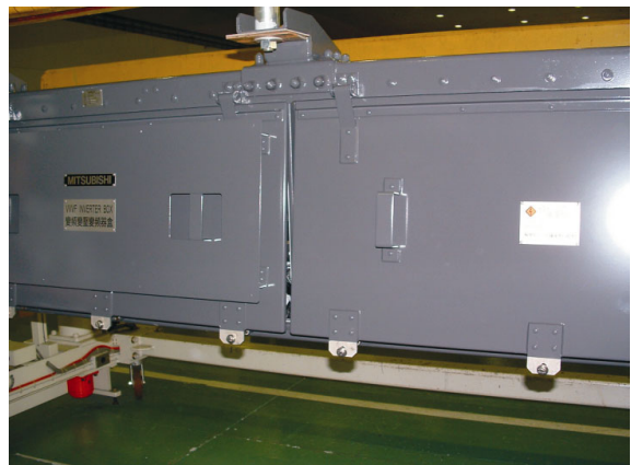
圖 3 變頻變壓換流器
