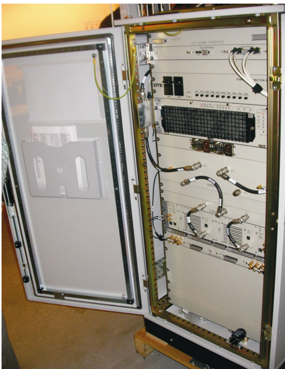
圖 2、無線電基地台設備
