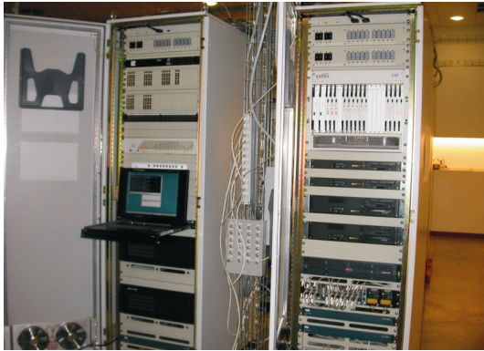
圖 5、無線電系統行控中心主控設備
