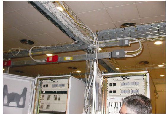
圖 6、無線電系統行控中心 主控設備電纜配置
