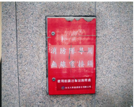
圖 9、消防無線電輔助設施
