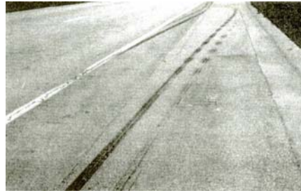
圖 5-6 Skip Skid Marks
