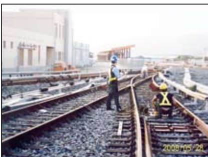
圖45 導電軌對導電軌直流電阻測試(測試端)
