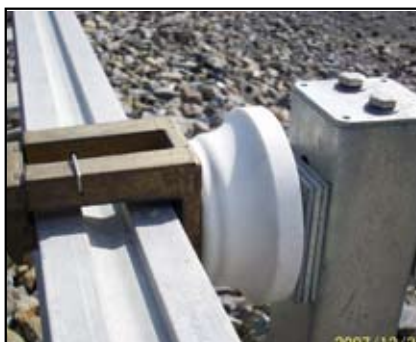
圖10 導電軌、導電軌絕緣礙子、導電軌支架之組合
