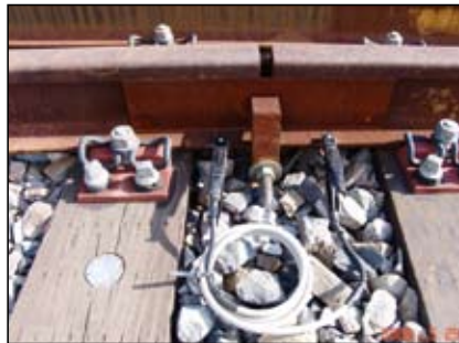
圖52 護軌對鋼軌電阻測試之 護軌跨接
