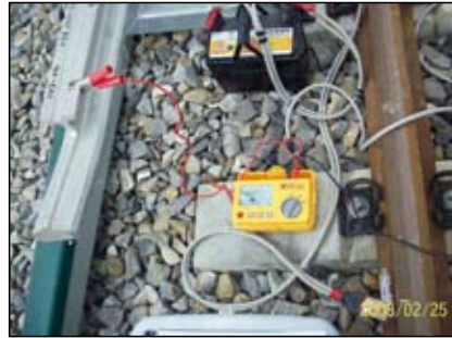
圖49 導電軌對地電阻測試 (測試端)
