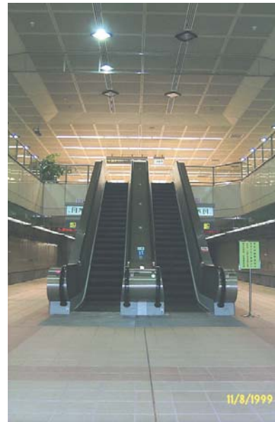
▲ 捷運車站電扶梯設備。
