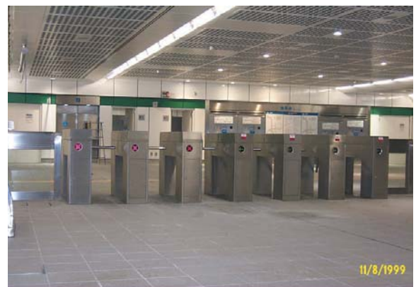
▲ 捷運車站自動收費閘門。
