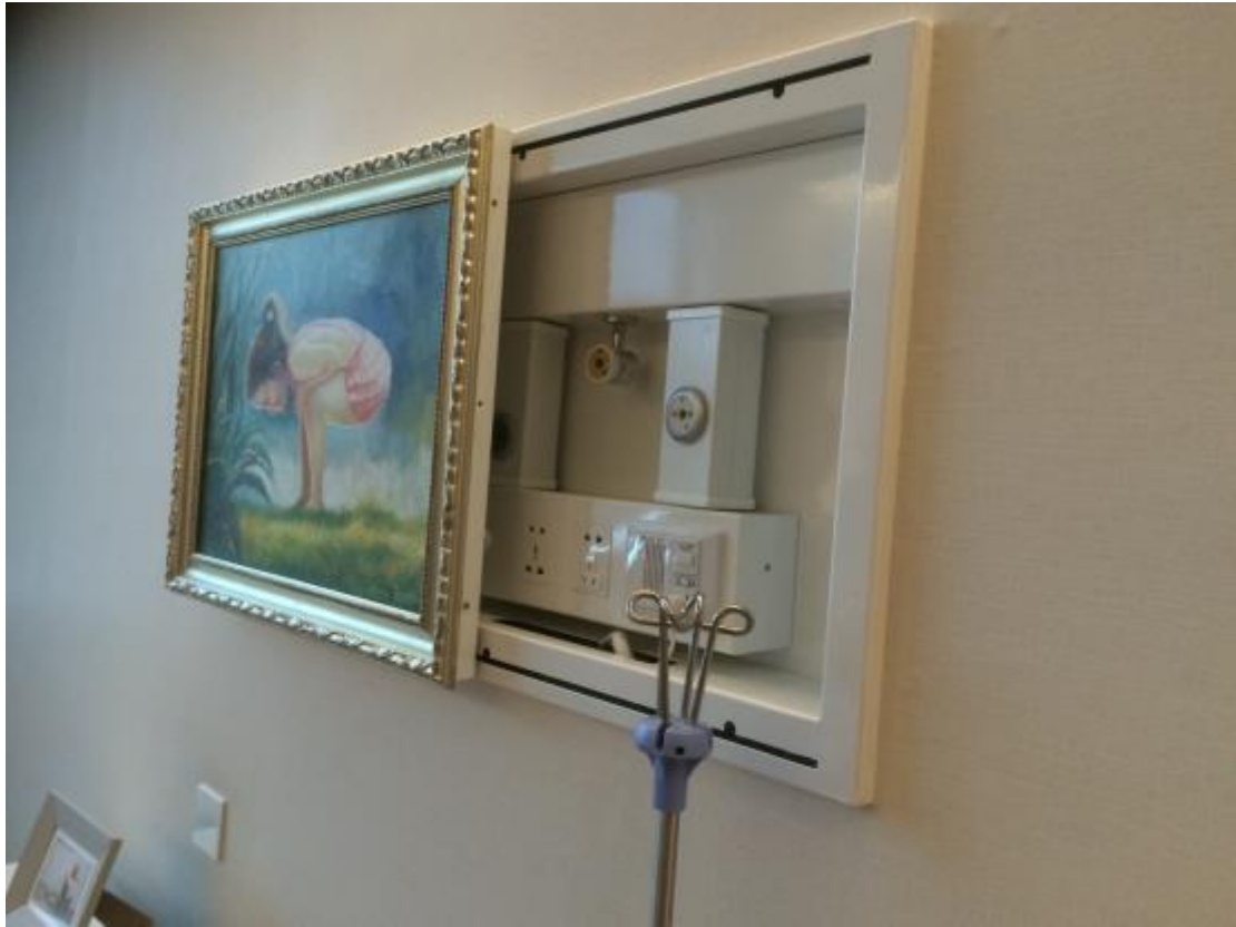
圖片九：禾新醫院病房控制面板藏於畫框後
