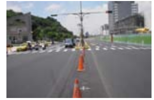
圖十二、南港線東延段南港站忠孝東路七段道路復舊完成
