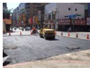
延平北路路基改善區塊級配改良後瀝青混凝土分層鋪設圖
